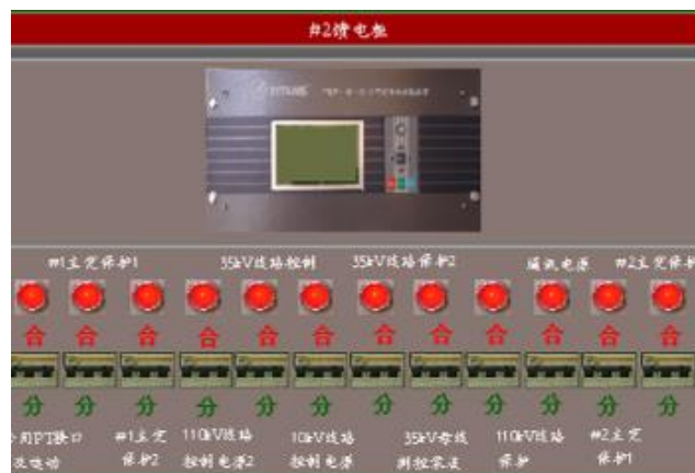
图 5-22 变电站 2#馈电柜
