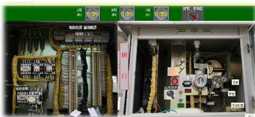
图 4-14 110kV 宗永线 1112 开关操作箱
