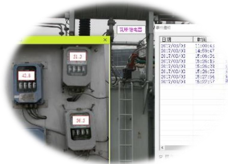
图 6-4 变压器温度检查
