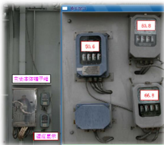
图 5-2 设备区#1 主变温度显示
